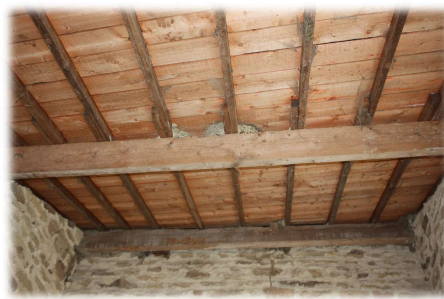
Les nids sont construits sur les poutres du bâtiment.
